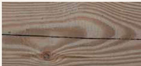
Fissures de contrainte provoquées par le séchage du bois
