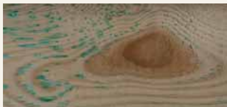
Efflorescences de sels d'imprégnation verdâtres
